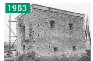
Nordwand vor der Restaurierung
